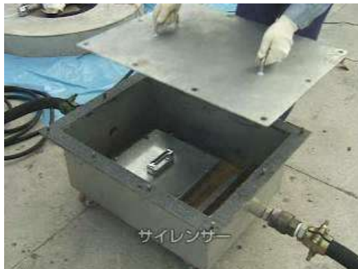
写真 4-1 サイレンサー内の設置状況
