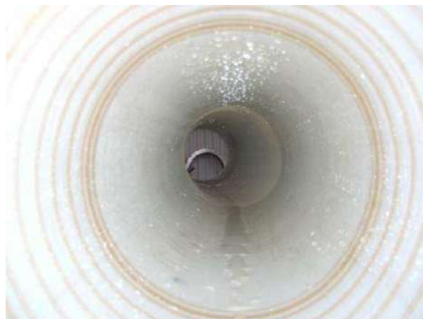
写真 57 最大軸方向変位量と最大屈曲角での管内状態
