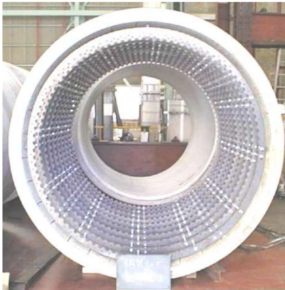
写真 9-2-3 呼び径 2,000 更生管
